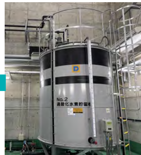
過酸化水素タンク
