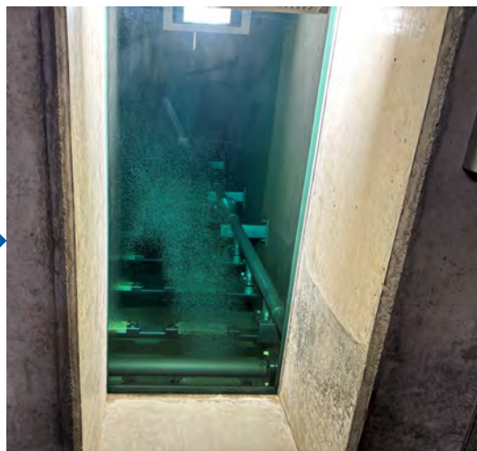
オゾン処理槽
